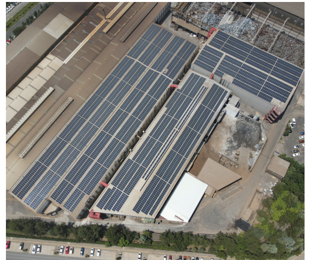
Çatı Güneş Enerjisi Santrali-1 (GES-1)
